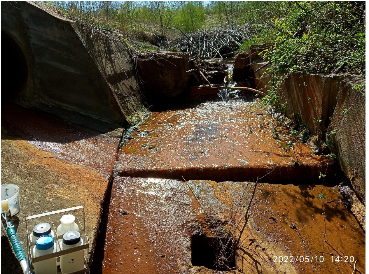
140 pav. Paviršinių lietaus nuotekų kanalas ties įtekėjimu į Šiladžio upelį. Ėminių paėmimo vieta Nr. V2.
