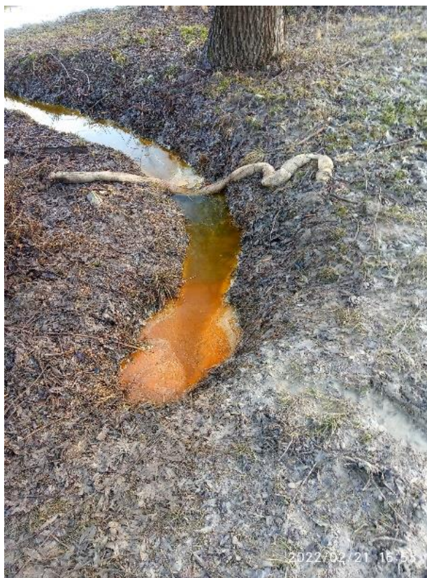
133 pav. Išsiliejusio aliejaus sankaupos paviršinio vandens surinkimo kanale ties Ukmergės g pralaida. Šioje vietoje įrengta absorbentų užtvara nesulaiko išsiliejusio aliejaus plitimo į kitoje gatvės pusėje esantį paviršinio vandens surinkimo kanalą.
